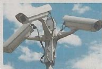
SECUREZZA Approvata in giunta una nuova delibera che ha previsto oltre 65 telecamere da installare in città
